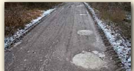
Durch das fehlende Dachprofil bleibt das Wasser auf dem Weg stehen; die Folge: zahlreiche Schlaglöcher.
